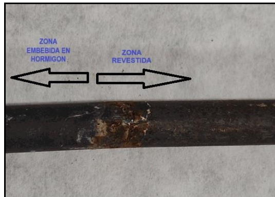
Fotografía nº15: «Detalle de corrosión férrica en barra en zona revestida»
